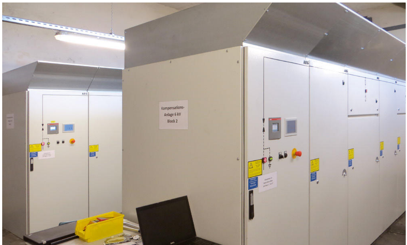
Störlichtbogengeprüfte Mittelspannungs-Kompensation 6 kV; 2 x 1.500 kVAr; P=7 %
